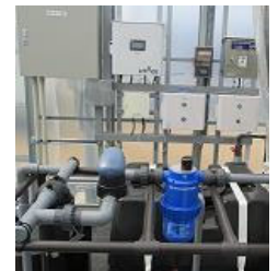
環境制御施設
